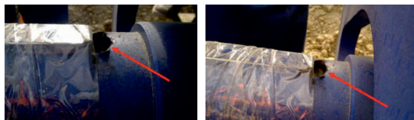
Рисунок 12 — Низкая культура производства арматуры от «псевдозавода»
